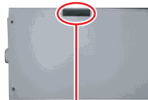
B 部（底面の隙間）
